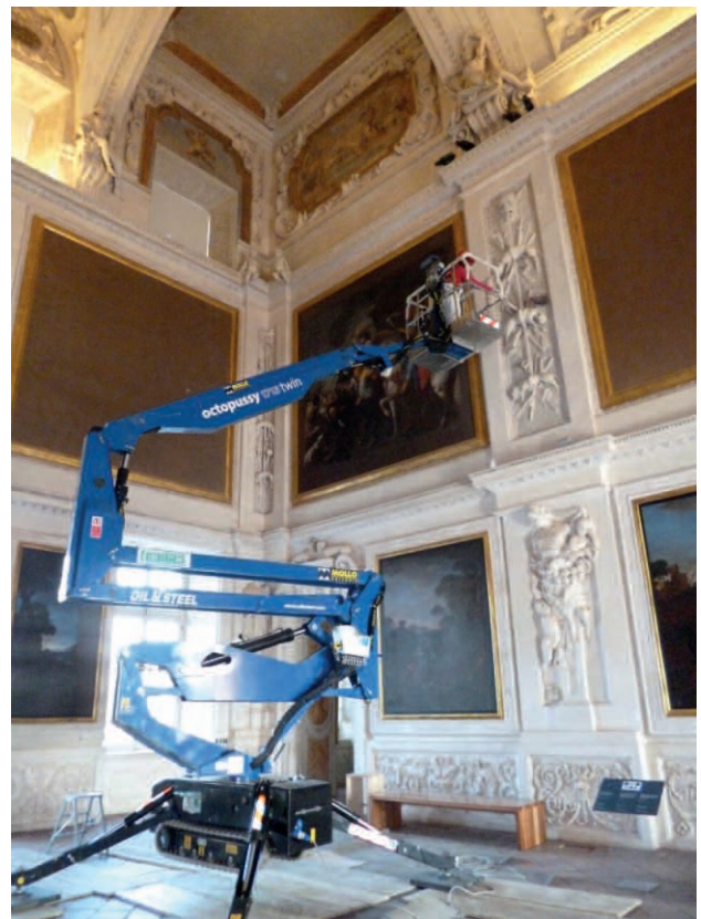
Fig. 1 - Attività di manutenzione programmata annuale sulle superfici decorate della Sala di Diana.
