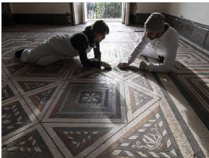
Restauratori al lavoro sul pavimento mosaico del Salottino di porcellana di Maria Amalia di Sassonia
