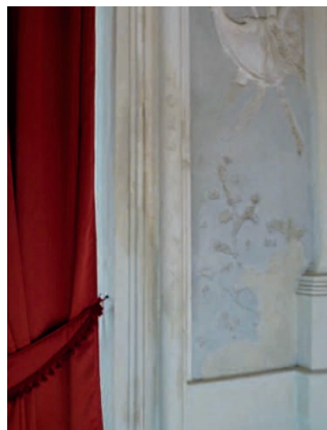
Particolare dell'area soggetta a esfoliazione degli strati di finitura.
