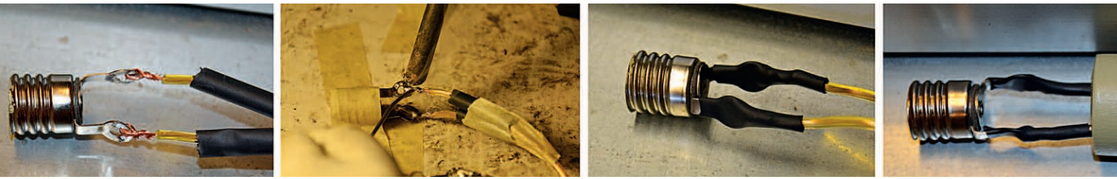
Fig. 8 - Particolari dell'impianto elettrico dei portalamпада.
