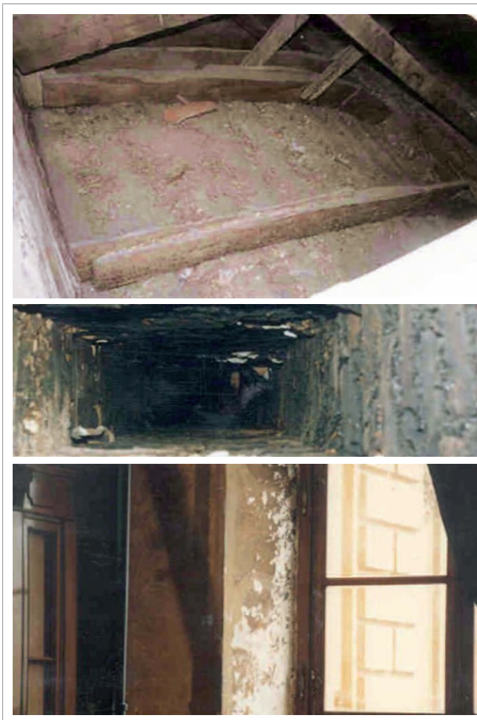
Fig. 3 - Rinfianco di volta, camino e muro degradato nel Castello del Valentino (1633-1660) a Torino.
